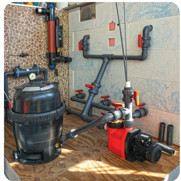
Filter mit Pumpe und Verrohrung
